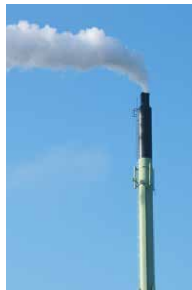
Antenner monteret på skorsten
